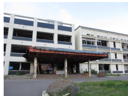
写真 4 津波に呑み込まれた市役所 (陸前高田市)
