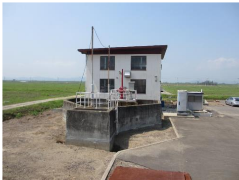
写真 7 被災した排水機場 (名取市関上)
