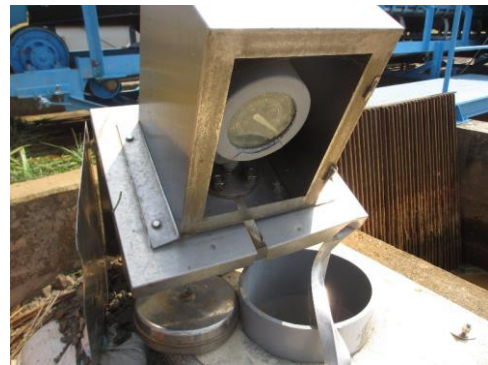
写真 8 津波により破損した 排水機場の計器
