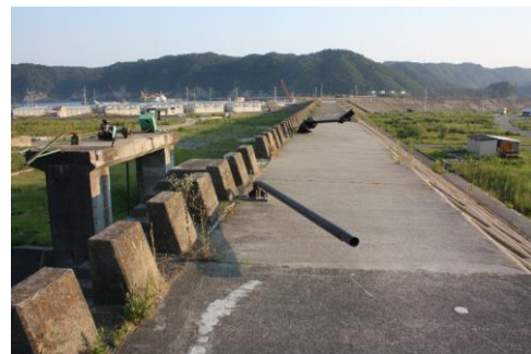
写真 2 防潮堤を越えて浸水 (宮古市田老町)
