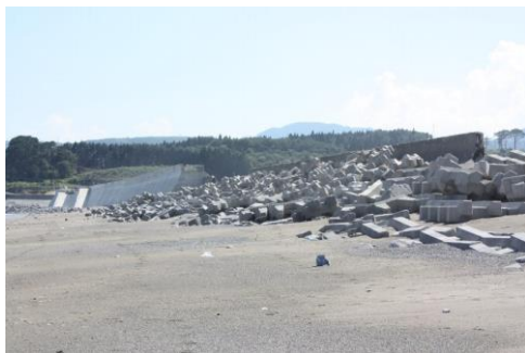
写真 1 防潮堤の破壊 (田野畑村)
