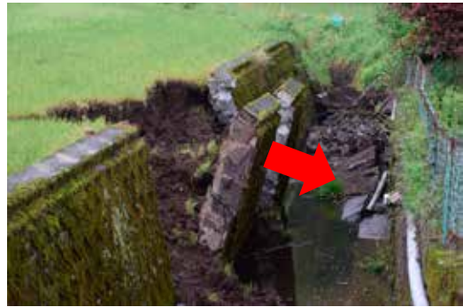
写真-4.4 地震による水田擁壁の崩壊
