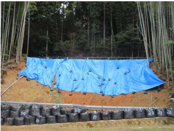
写真-1 道路斜面の崩壊（北九州市）
