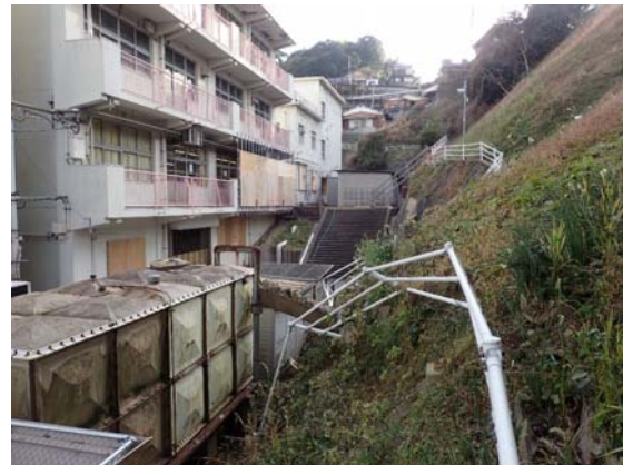
写真-2 小学校裏の斜面の崩壊（北九州市）
