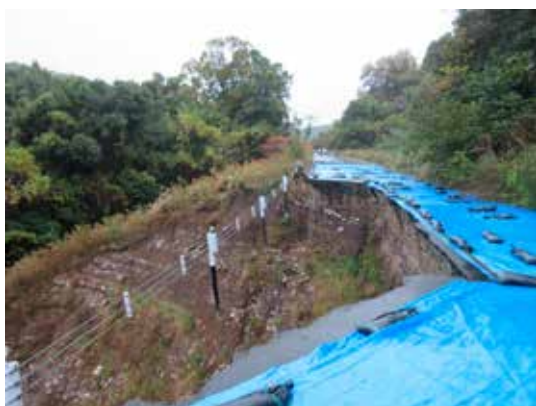
写真-5 芦北町の農道被害
