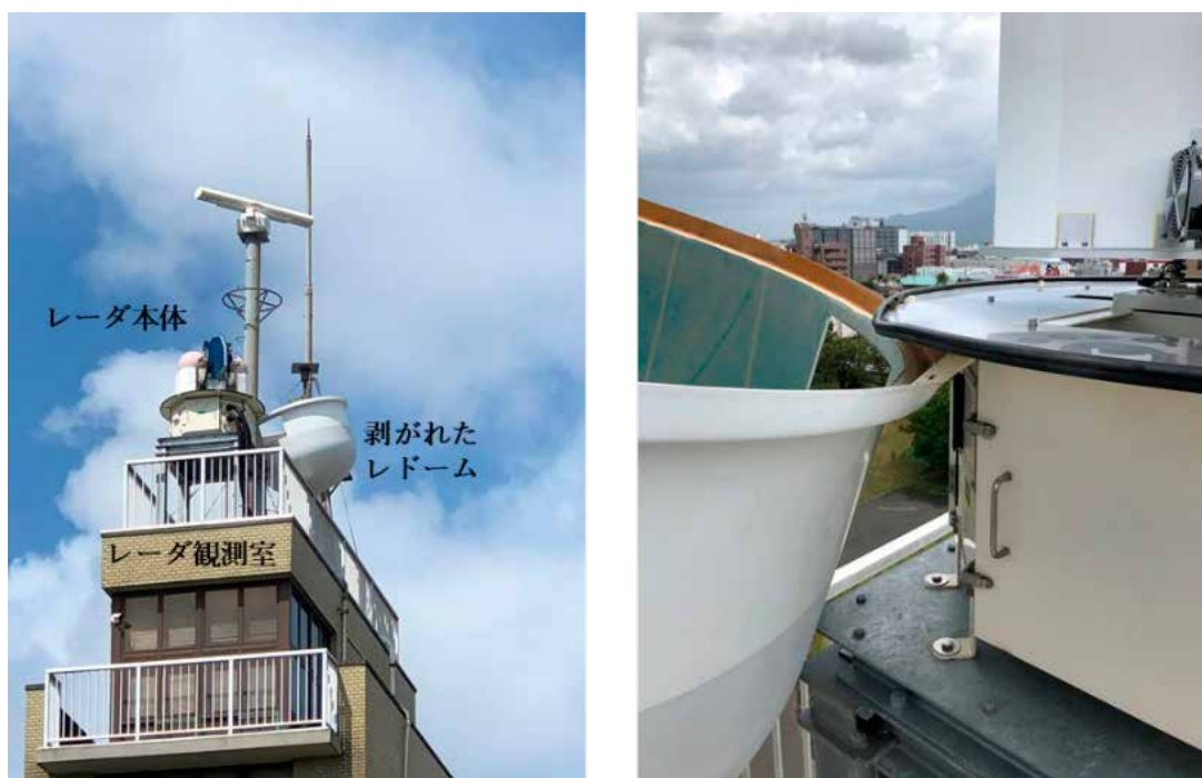
図 3.2.1 左：レーダ本体と剥がれたレドーム，右：レーダドーム接続部。
