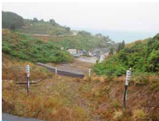
写真-6 法面の崩壊（芦北町鶴木山）
