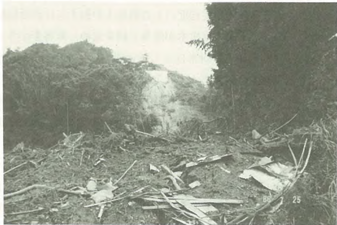
写真一9 田上一丁目崩壊地
