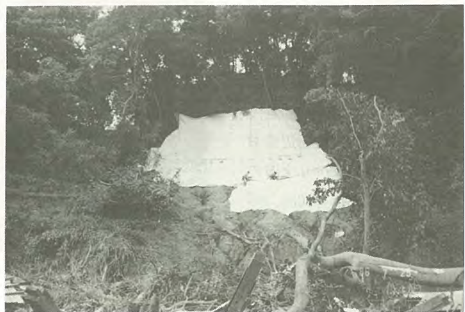
写真—5 新照院町崩壊地
