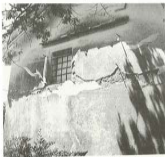
写真6 4月3日の地震で剥離が生じた伊藤家の蔵 (5月9日撮影)
