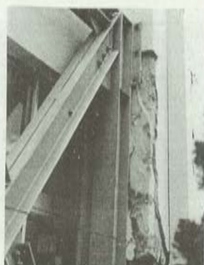
写真 29 宮之城農業高校管理棟北面の ブレースのアンカーボルトの破損
