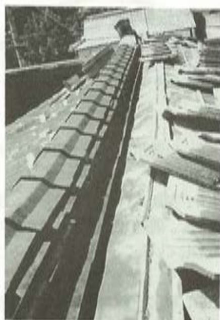
写真6 棟瓦部分の損傷
