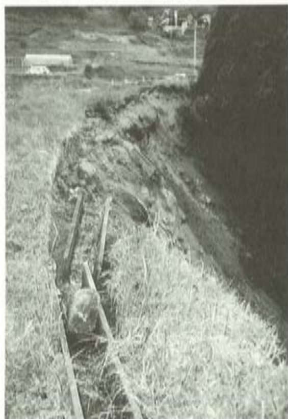
写真4 斜面の崩壊により被害を受けた水路 （泊野地区）
