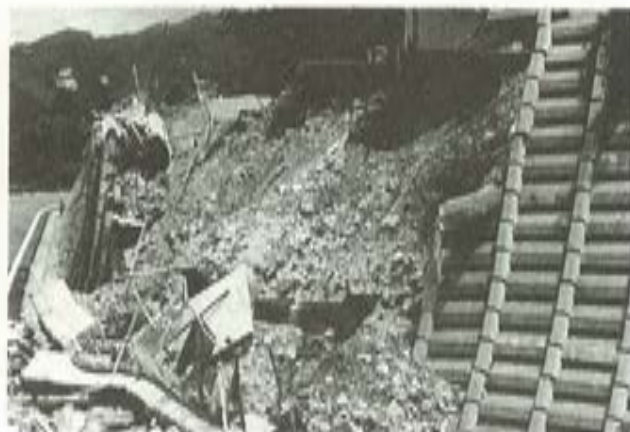
写真29 擁壁の崩壊と上部の住宅の損壊
