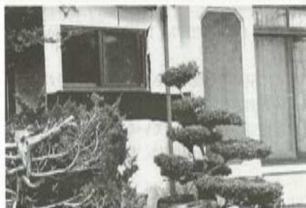
写真16 モルタル外壁の亀裂と剥離
