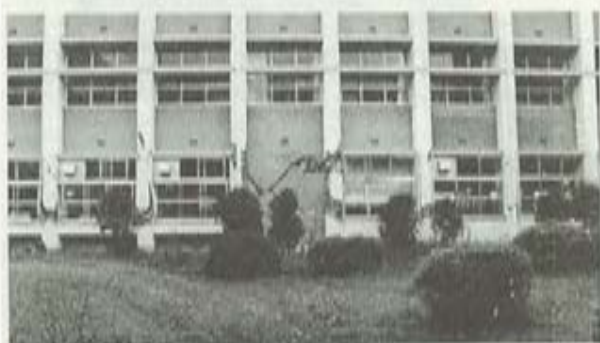
写真 16 宮之城高校特別教室棟南面中央部の損傷
