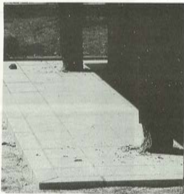
写真6. 阿久根漁港外港の公園施設の破損状況。
