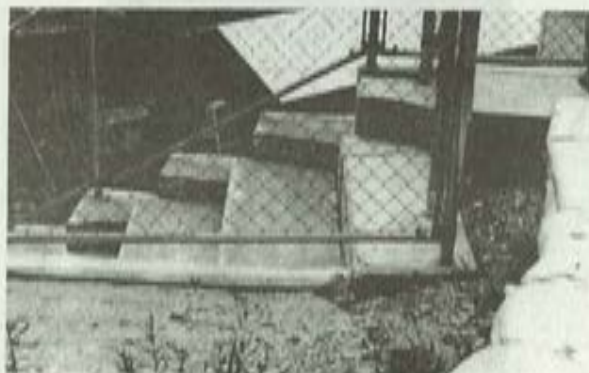
写真7 平川小の地盤沈下(擁壁と手前の階段を含む 地盤の間に約20cmの不同沈下が観察された)
