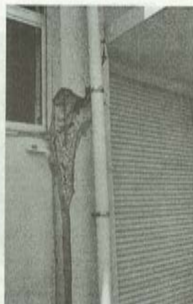
写真 40 川内商工高校機械実習棟 の短柱3の剪断亀裂(余震1後)
