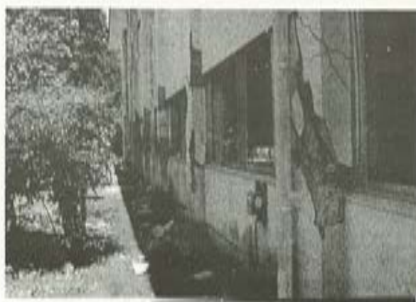
写真 13 鶴田小の特別教室棟北面柱の剪断破壊
