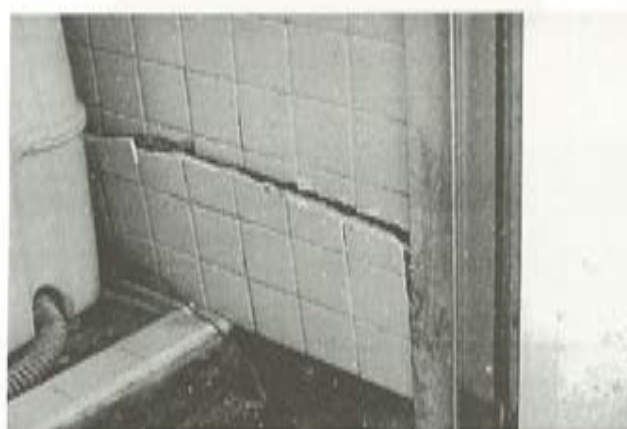
写真14 浴室タイルの剥離と亀裂
