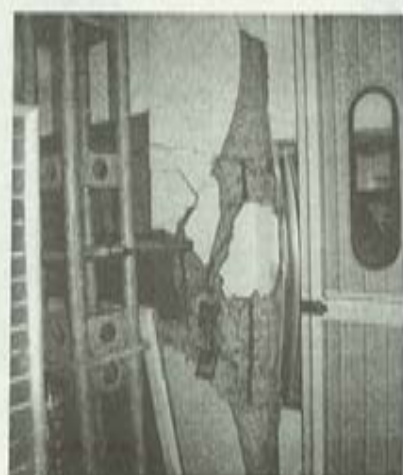
写真 42 川内商工高校機械実習棟 の短柱2の剪断破壊(本震2後)
