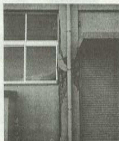
写真 43 川内商工高校機械実習棟 の短柱3の剪断破壊(本震2後)
