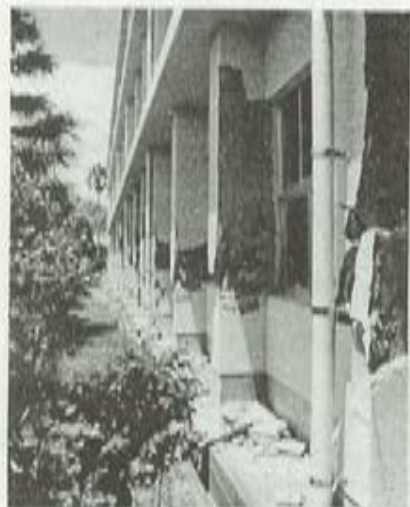
写真 26 宮之城農業高校管理棟南面東側の 損傷(ほぼすべての柱に顕著な剪断破壊)
