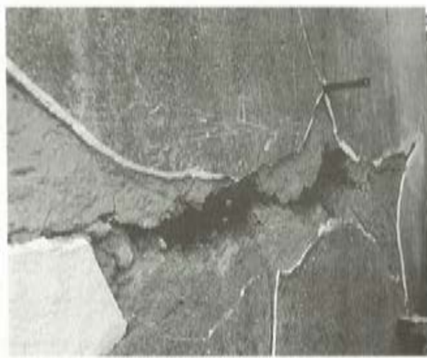
写真7 5月16日の地震で亀裂が一層大きくなる伊藤家の蔵 (5月19日撮影)
