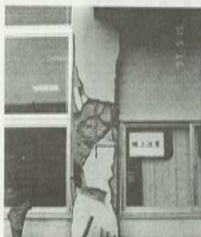
写真 41 川内商工高校機械実習棟 の短柱1の剪断破壊(本震2後)
