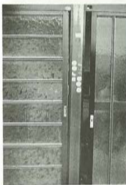
写真9 アルミサッシの建て付け
