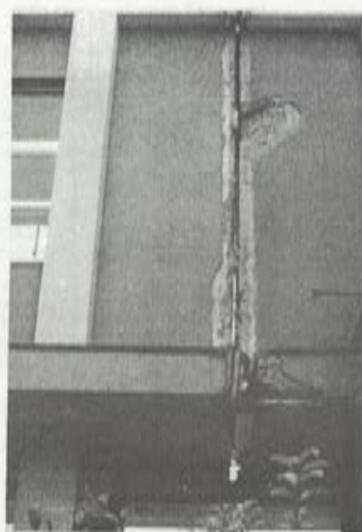
写真 23 宮之城高校管理教室棟と渡り廊下棟のエキスパンション・ジョイントの損傷
