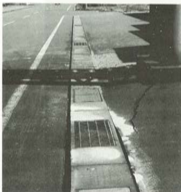
写真5. 阿久根漁港外港事務所付近の亀裂と噴砂現象。
