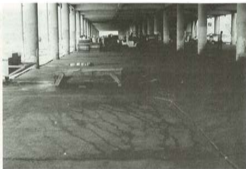
写真-2.1 新港水揚げ場付近の不等沈下
