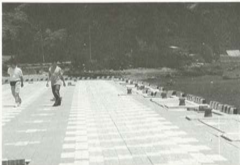
写真-2.7 川内港京泊での舗装ブロックの変状
