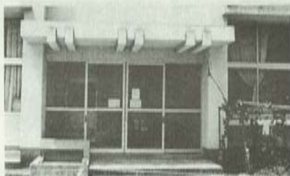
写真6 柱の剪断亀裂(写真3の出入口と反対側)
