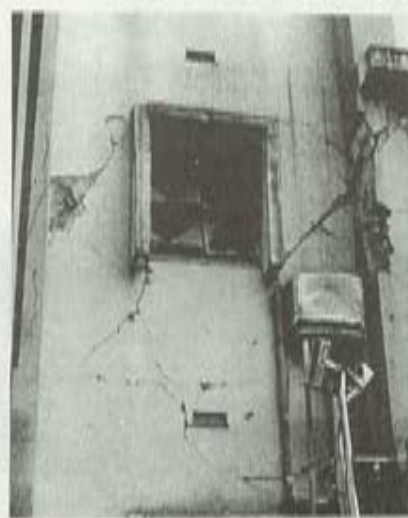
写真 31 宮之城農業高校特別教室棟南面西側の 有開口壁の剪断亀裂 (本震 2 後、2 階部分に剪断亀裂)
