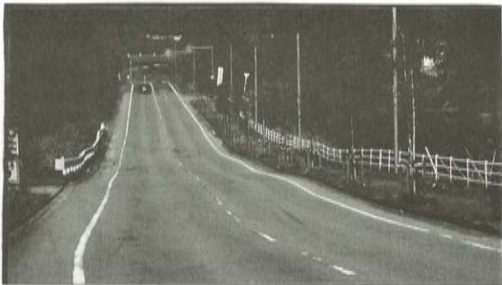
写真1. 宮之城町平川の国道328の盛土部の被害状況（道路が波打って、多数の亀裂が認められる）。
