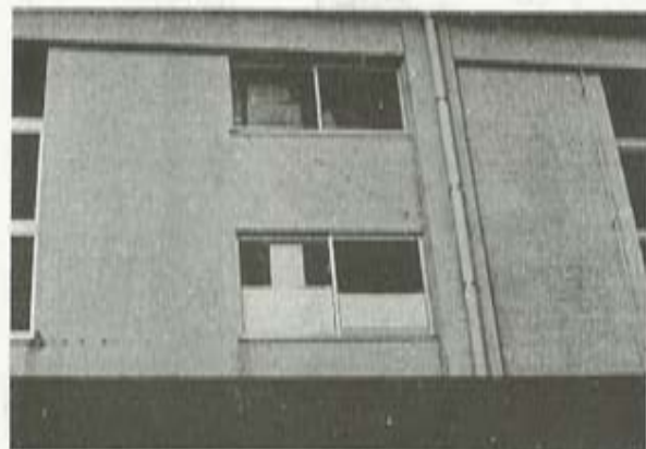
写真 46 川内商工高校機械実習棟西側の雑壁 (剪断亀裂と柱の曲げ亀裂)
