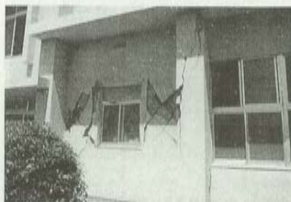
写真 25 宮之城農業高校管理棟南面西側の有開口壁の 剪断破壊(本震 1後)
