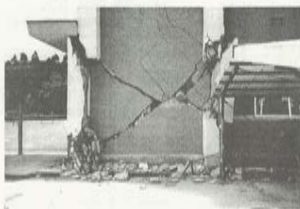
写真 22 宮之城高校特別教室棟北面東端の耐震壁の剪断破壊
