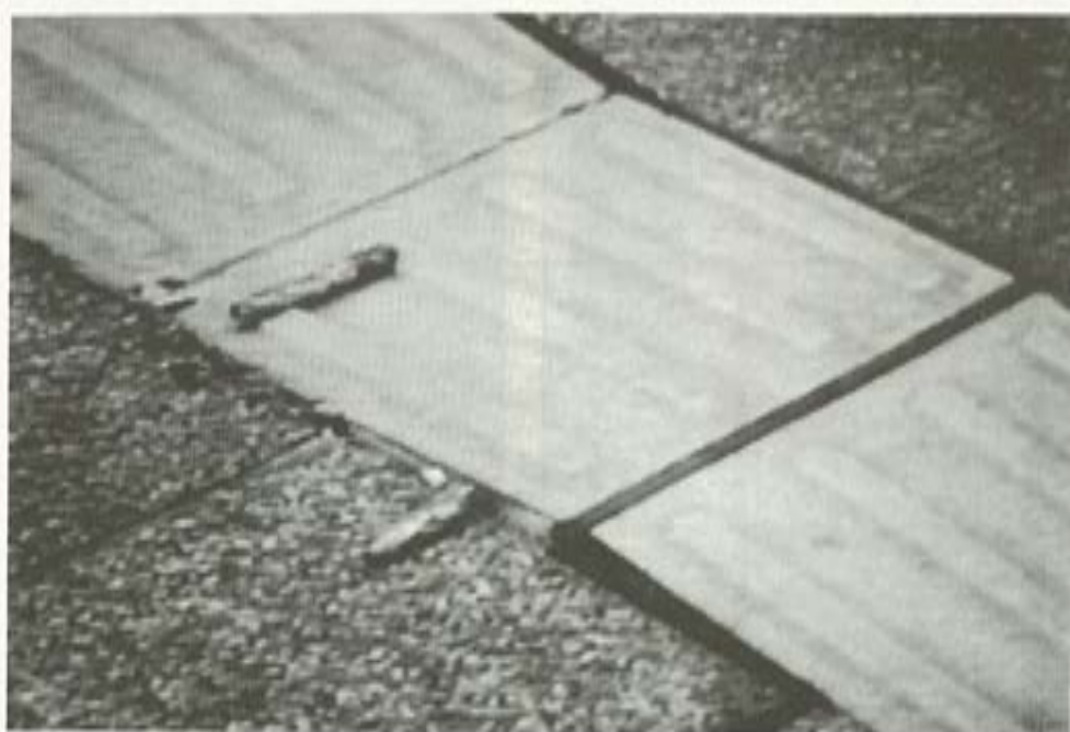
写真9. 鹿児島県庁敷地内における石板の盛り上がり.
