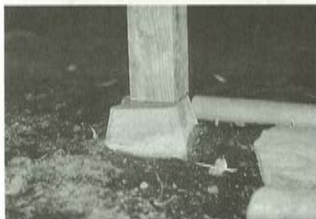
写真11 東石の沈下回転と束の変形
