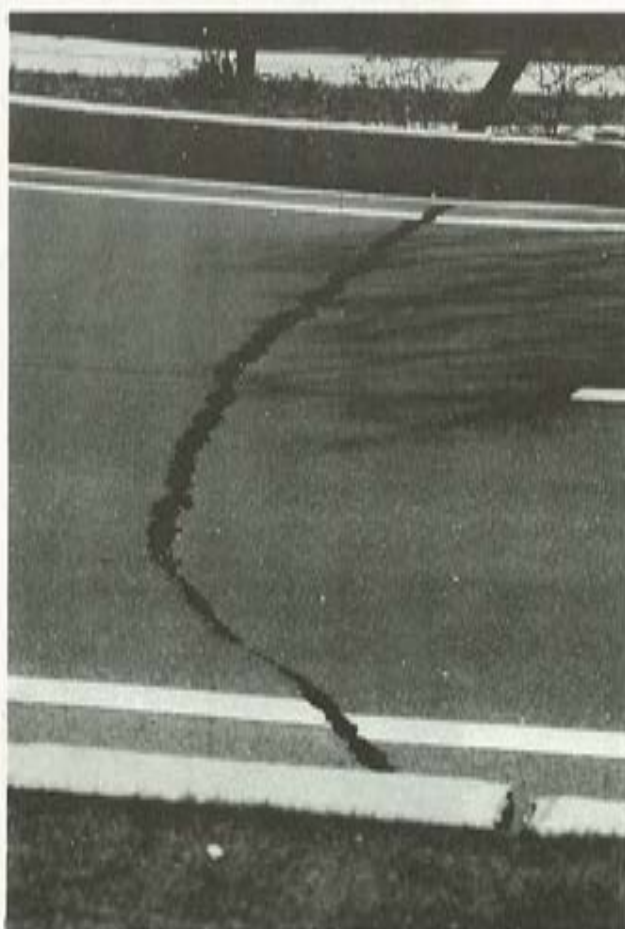
写真8. 阿久根駅前通りの、市街地と漁港の境界付近に見られる亀裂。
