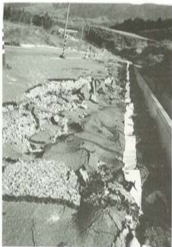
写真1 パイプラインの破損による 農道の被害（泊野地区）
