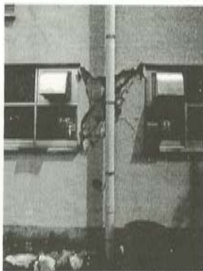
写真 9 盈進小の短柱の剪断破壊
