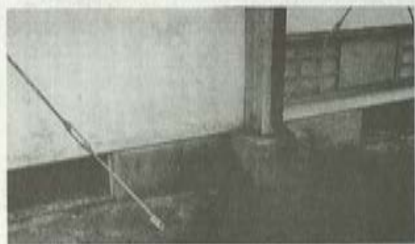
写真 37 宮之城農業高校武道場(ブレースとガセット プレートを接合していたボルトの破断)
