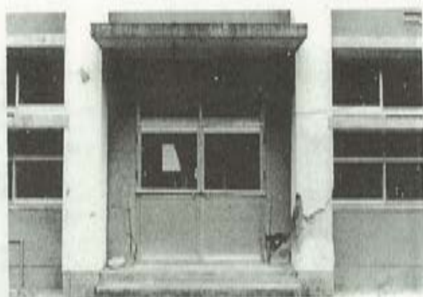
写真 15 宮之城高校管理教室棟の袖壁付柱の剪断破壊
