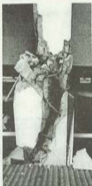
写真 19 特別教室棟の柱の 曲げ剪断破壊 (写真 18 左の柱)
