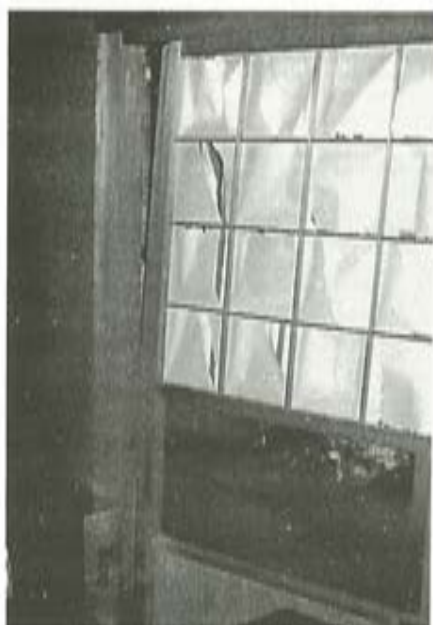
写真12 柱の変形による障子の変形
