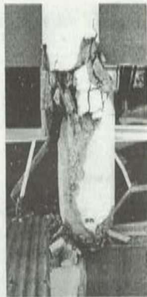
写真 20 特別教室棟の柱の 曲げ剪断破壊 (写真 18 左から 5 番目の柱)
