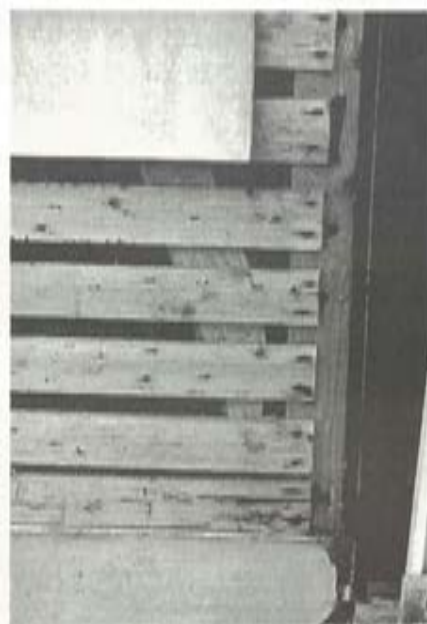
写真20 筋違の施工不良
