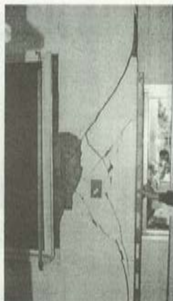
写真 39 川内商工高校機械実習棟 の短柱2の剪断亀裂(余震1後)
