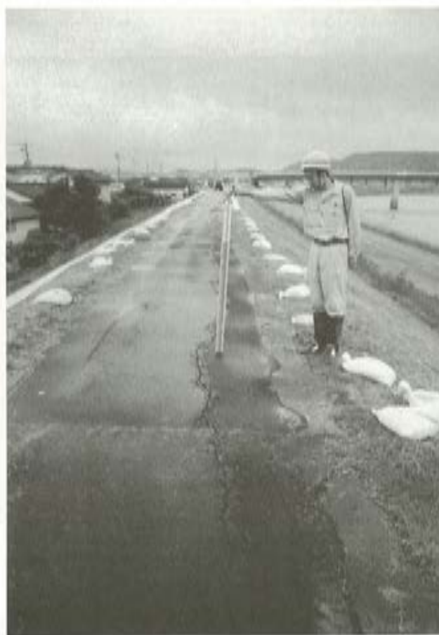
写真-3.1 天大橋付近の堤防の縦断亀裂
