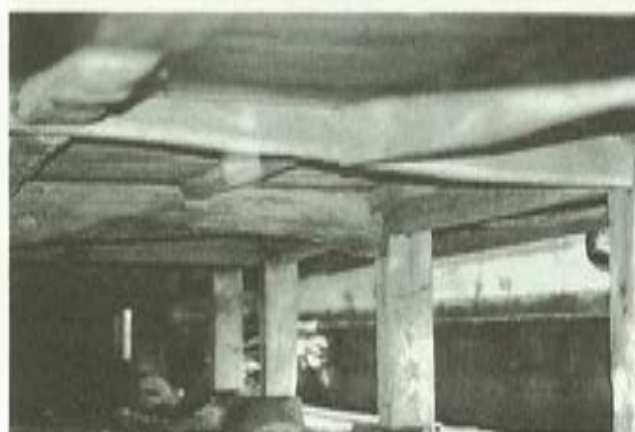
写真10 東石の沈下と束の変形
