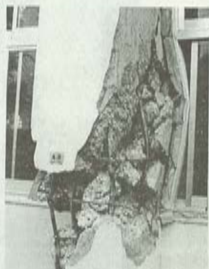
写真 28 管理棟の柱の曲げ剪断 破壊 (写真 26 右から 2 番目の柱)
