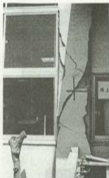
写真 38 川内商工高校機械実習棟 の短柱1の剪断亀裂(余震1後)
