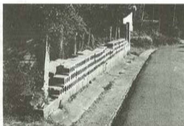
写真28 ブロック塀の倒壊（無筋）
