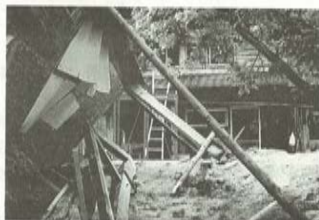
写真22 マサ土の崩壊による被害
