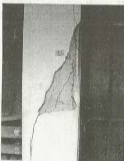
写真 49 川内高校特別教室棟北側1階の 柱の剪断亀裂(本震2後)
