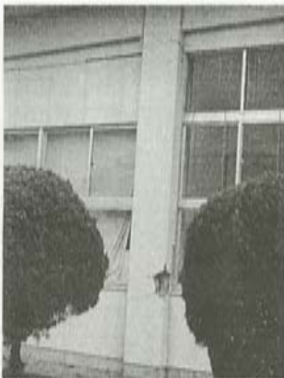
写真 45 川内商工高校機械実習棟の 長柱の曲げ破損(本震2後)
