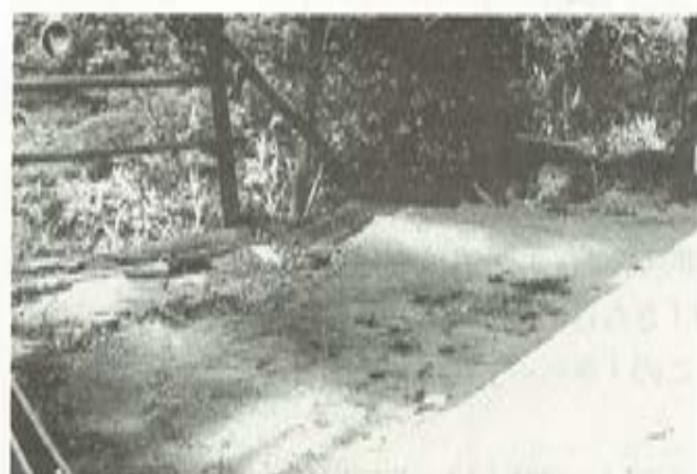
写真21 宅地法肩部の崩壊と沈下
