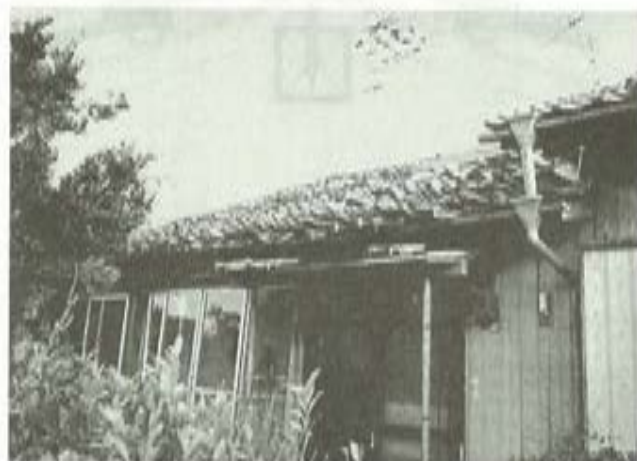
写真5 瓦の全体崩壊
