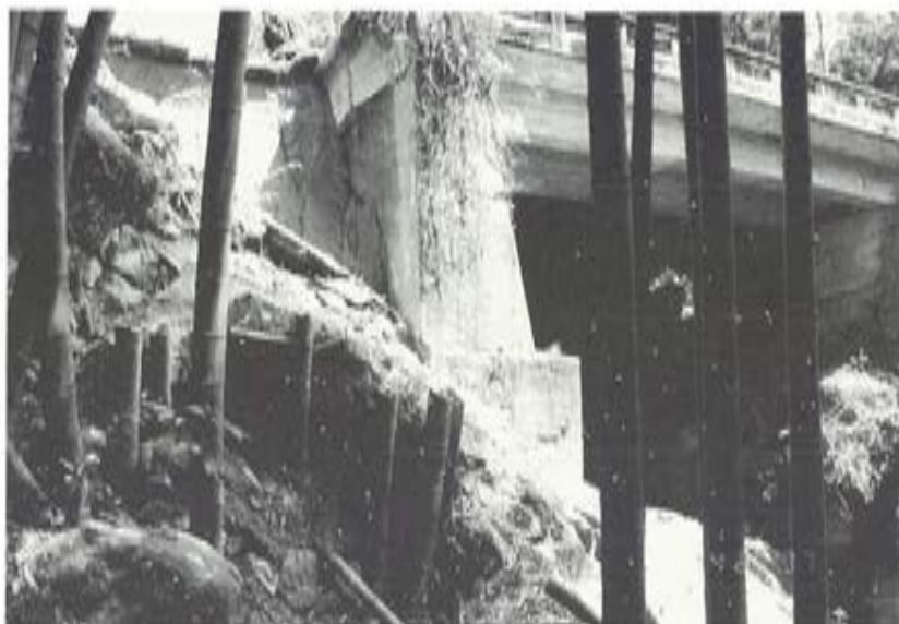
写真1 3月の地震後の市野橋 右岸下流側橋台
