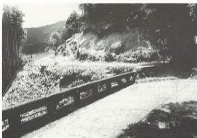
写真2 3月の地震後の右岸取り付け道路
