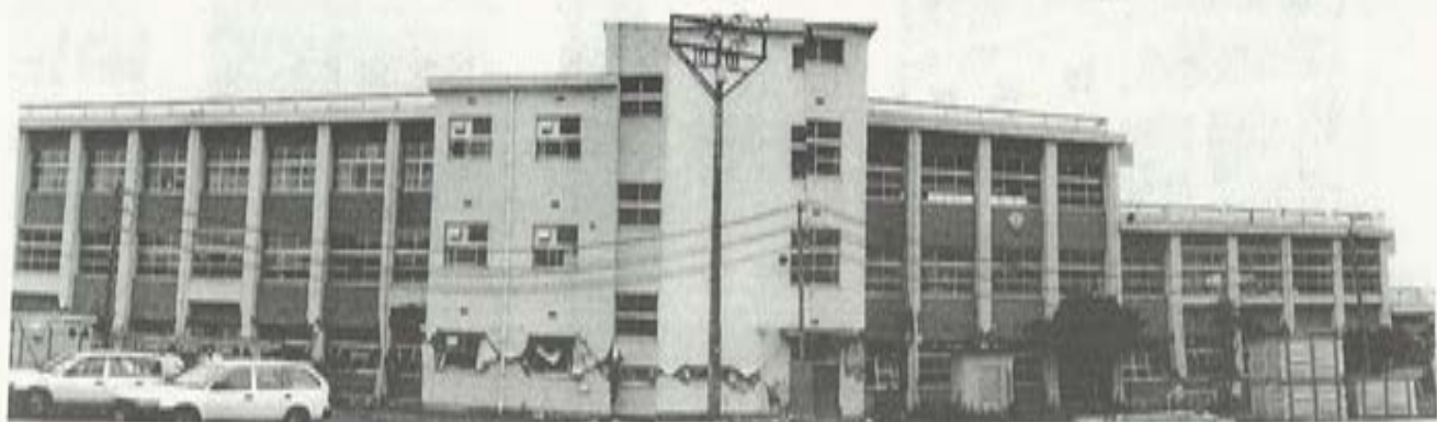
写真 21 宮之城高校特別教室棟北面の損傷
