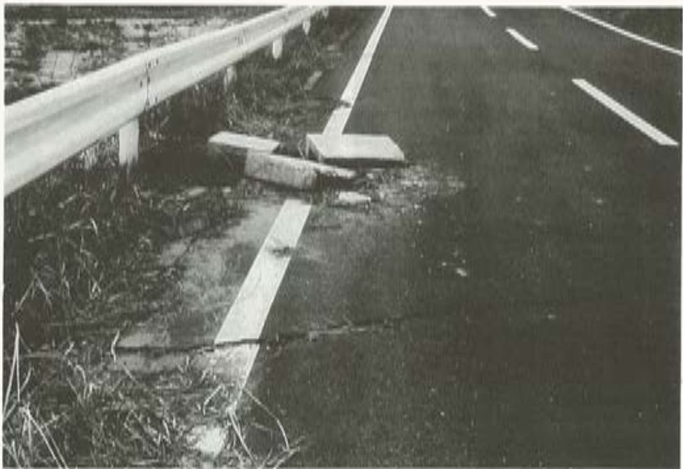
写真4. 宮之城町虎居甫立集落北方の農業用施設3ブロックの側溝蓋の跳ね上がりと亀裂。
