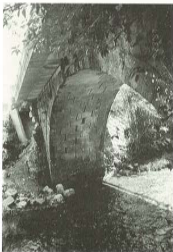
写真4 大薄橋 アーチリング腹面と左岸護岸部の破損状況
