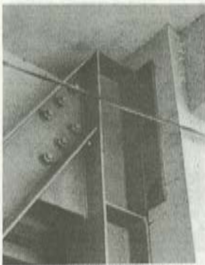
写真 32 宮之城農業高校特別教室棟北面の ブレースのアンカーボルトの破断
