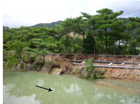
写真-4 浦川左岸の被災状況
