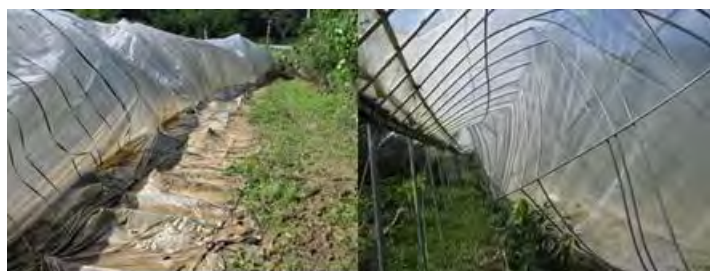
写真11 マンゴーハウスの被害（龍郷町）
