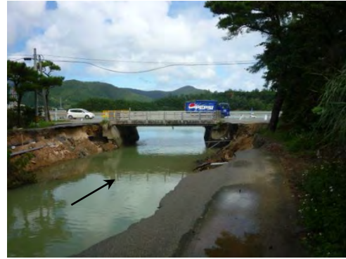
写真-2 被災後の浦川河口の状況
