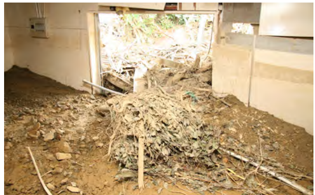
土石流が流れ込んだ展示通路
