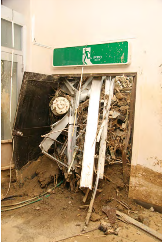
非常口に土石流が押し寄せた第1展示室
