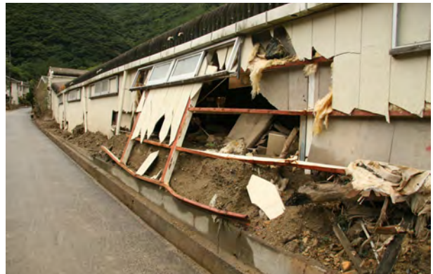
土石流が内部から破壊する展示通路
