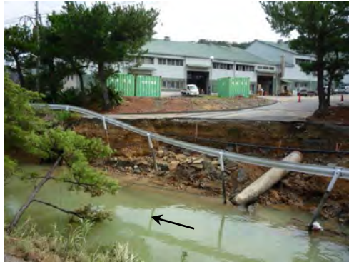
写真-3 浦川右岸の被災状況
