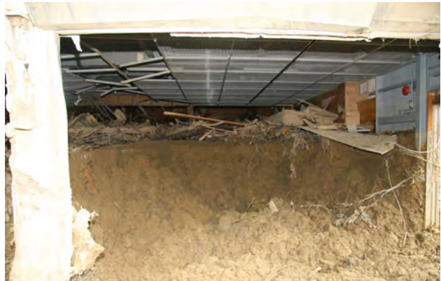
土石流の流れ込んだ第2展示室
