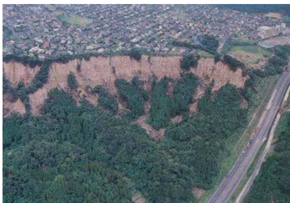
写真 3.1.2 始良町平松始良ニュータウン周辺のシラス台地の崩壊（国際航空写真株式会社撮
