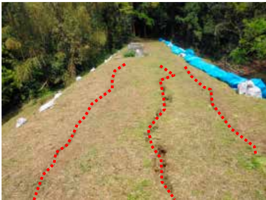
写真-4.5 仮宿ため池の損傷 (大津町)
