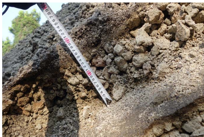
写真-5 崩壊箇所の表層土の状況
