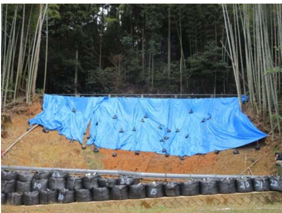
写真-1 道路斜面の崩壊（北九州市）
