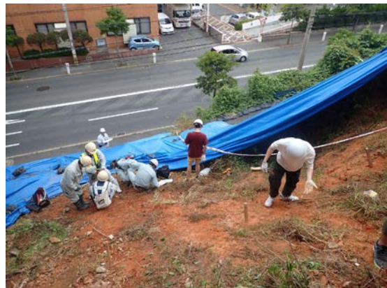
写真-4 斜面崩壊状況調査（頂部より）
