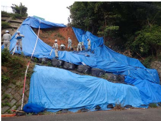
写真-3 斜面崩壊現場（北九州市門司区）
