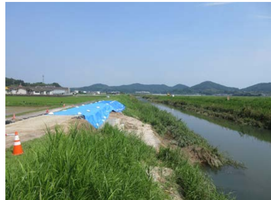
写真-2 河川堤防法面の崩壊（大里川右岸）
