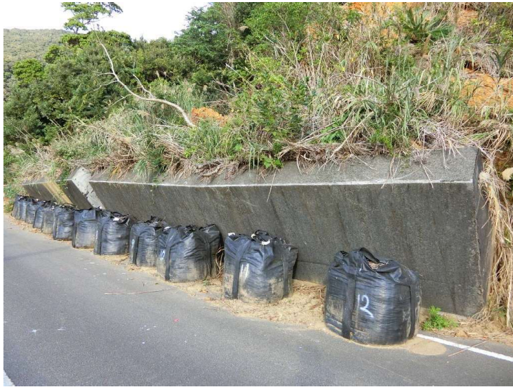
写真10 道路擁壁の転倒(西古見地区)
