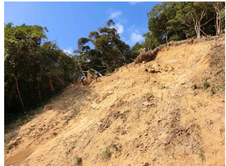
写真9 道路斜面の崩壊(西古見地区)
