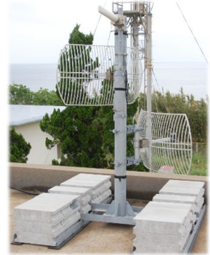
こちらは、高速通信網未整備離島において無線LANにより通信ネットワークを構築した際を中心となるアンテナ設備です。当該離島には現在では光ファイバ網が整備されており、当該アンテナ設備は撤去済みです。
