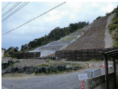
写真-1 平成 30 年古里地区のがけ崩れ現場
